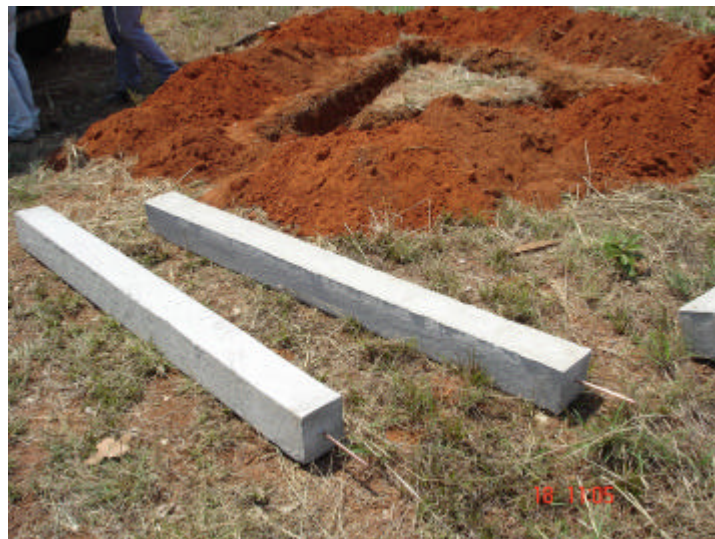
Figura 4 – Malha de Aterramento com Hastes Concretadas.
