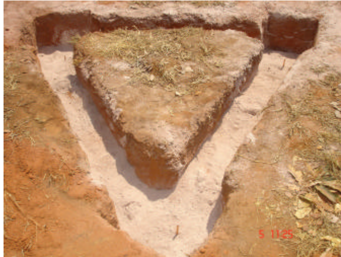
Figura 3 – Malha de Aterramento com Tratamento Químico do Solo.
